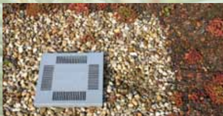
Entwässerungsschacht Mit Kieseinfassung.
